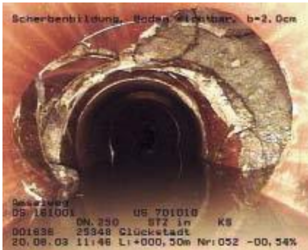
Abb.: Defekte Kanalrohre: Beispiel einer Untersuchung in Glückstadt.
