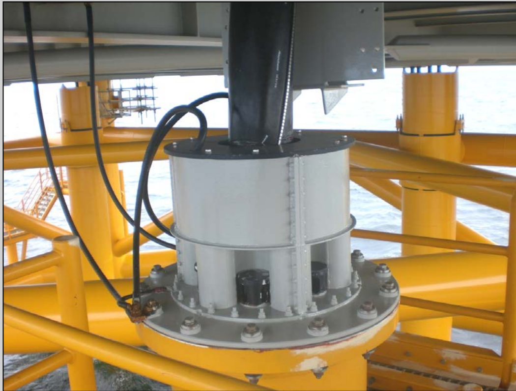
Schutzhaube für eine Umspannplattform eingebautem Zustand
